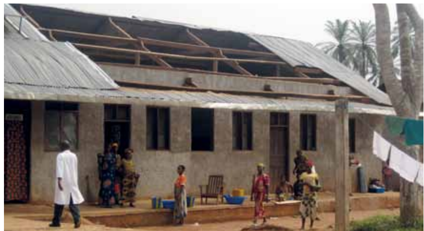
Tijdens een tropische storm is het dak van de materniteit ingestort. De schade is inmiddels hersteld met gelden uit het steunfonds van ZOL.
